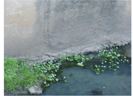
Foto 3 - Vista do pé do muro de contenção inferior da margem direita, com início de solapamento
