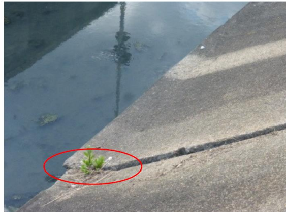
Foto 2 - Vista da laje inclinada da porção trapezoidal do canal com deslocamento no sentido transversal do canal, lado da margem esquerda
