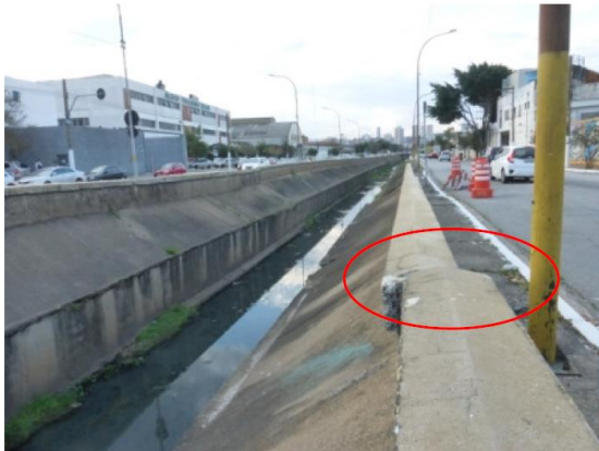
Foto 1 - Vista geral do canal no trecho interditado devido à movimentação ocorrida na mureta de contenção, trecho da margem esquerda em frente a Rua Nova Hamburgo
