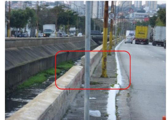
Foto 4 - Vista da mureta de contenção, trecho da margem esquerda, trecho à montante da Rua Nova Hamburgo, nota-se o desalinhamento da guia devido à movimentação ocorrida
